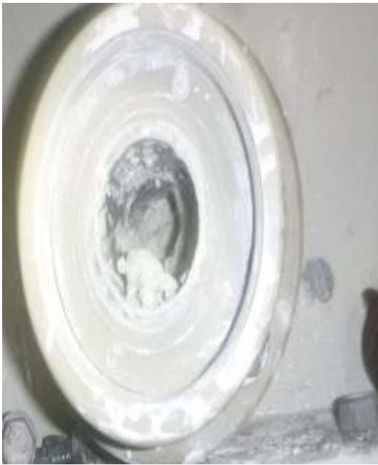
Gambar 3. 6 Penyumbatan pada pipa air kapur
