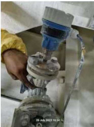
Gambar 3. 7 Retaknya Pressure Transmitter
